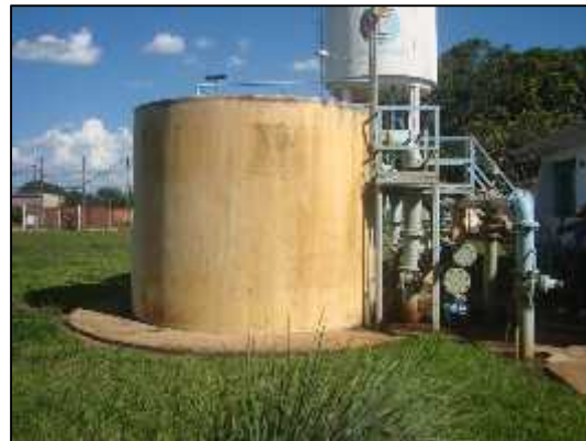
Figura 6. Tratamento de água - Araguaçu.
