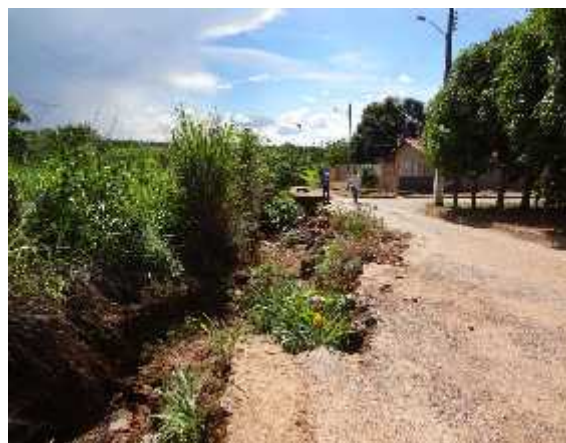
Figura 21 - Ponto crítico de drenagem
