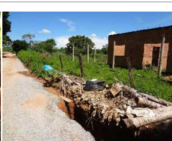
Figura 13 – Ponto crítico de drenagem
