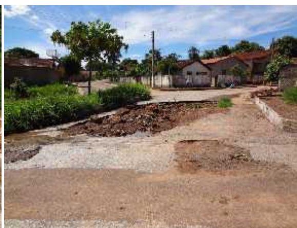
Figura 15– Erosão em via pavimentada
