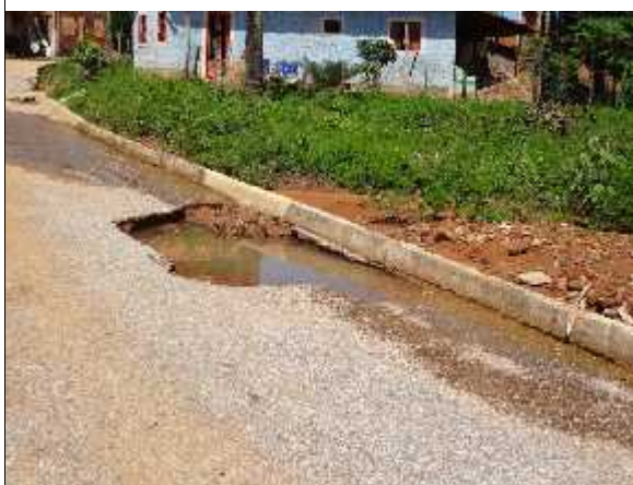
Figura 14– Problema de drenagem superficial
