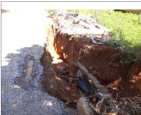
Figura 12- Erosão ponto crítico de drenagem
