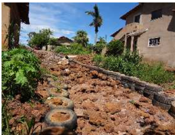
Figura 20 - Erosão em via não pavimentada
